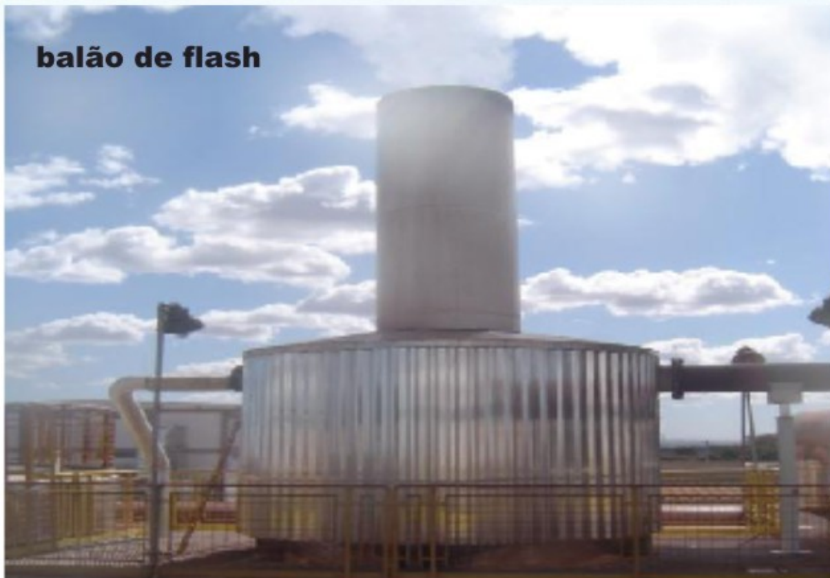
exemplo de um bom flashamento
